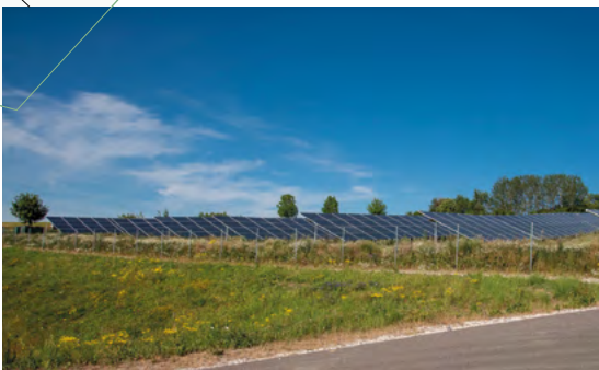
Solarpark Malborn Inbetriebnahme 2017 (Malborn)
