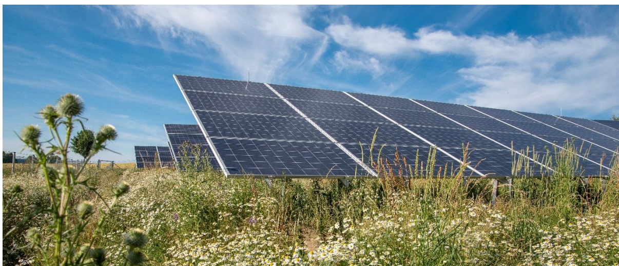
© ABO Energy - Parc photovoltaïque des Essards en France
